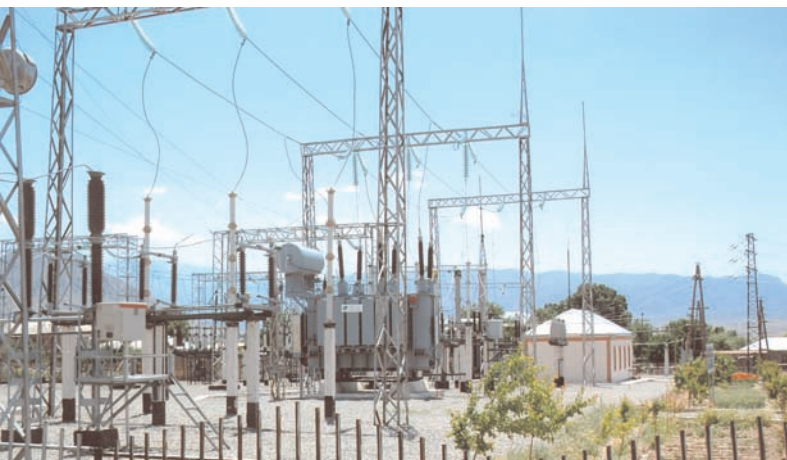
Culfa rayon yarımstansiyası.
