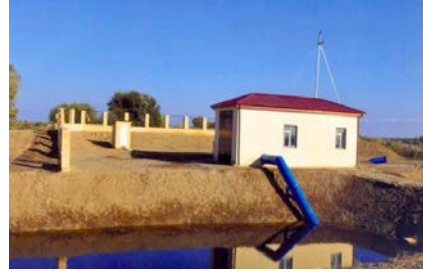
Salyan rayonu, OD kollektoru üzərində nasos stansiyası
