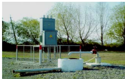
Ağstafa rayonu, Dağkəsəmən kəndində subartezion quyusu
