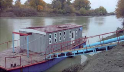
Kürdəmir rayonu, “Xələsə” üzən nasos stansiyası
