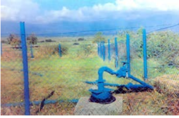
Şəki rayonu ərazisində Acınovur qış otlağı massivində artezian quyusu
