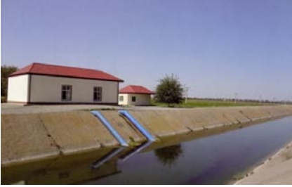
Şəmkir rayonu, Qaracəmilli nasos stansiyası
