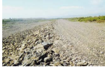
Qazax rayonu, Kür çayında sahilqoruyucu torpaq bənd
