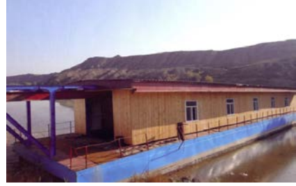
Tovuz rayonu, üzən nasos stansiyası
