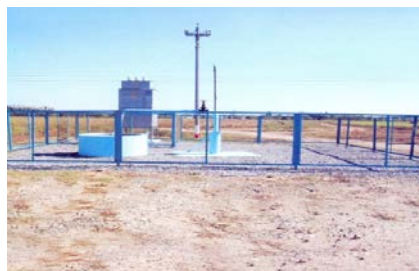
Ağcabədi rayonu, Yuxarı Qiyaməddinli kəndində subartezion quyusu
