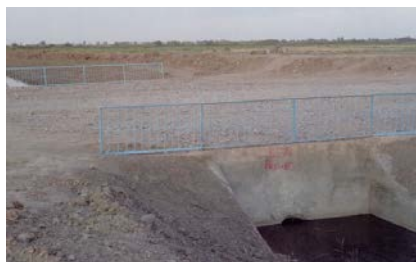
Ağdaş rayonu DS-4 kollektorlarında sukeçirən qurğu
