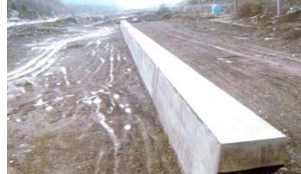
Qəbələ rayonu, Bumçay çayında sel və daşqın sularına qarşı beton bənd
