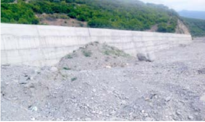
Şəki rayonu, Qurucanaçay çayında sel və daşqın sularına qarşı beton bənd
