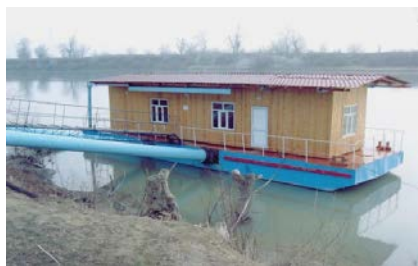
Ağdaş rayonu, Kür çayında üzən nasos stansiyası
