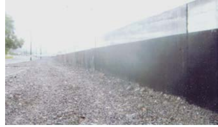
Qəbələ rayonu, Dəmiraparaçay çayında sel və daşqın sularına qarşı beton bənd
