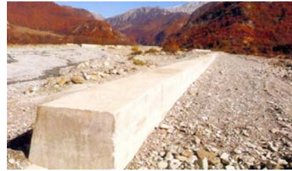
Oğuz rayonu, Daşaqılçay çayında sel və daşqın sularına qarşı beton bənd
