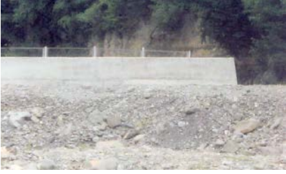
Şəki rayonu, Kişçay çayında sel və daşqın sularına qarşı beton bənd
