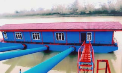
Hacıqabul rayonu, “Şirvan-4” üzən nasos stansiyası
