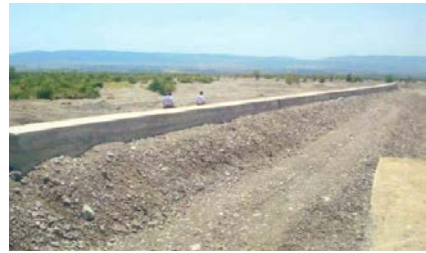
Daşğulçay çayında sel və daşqın sularına qarşı beton bənd
